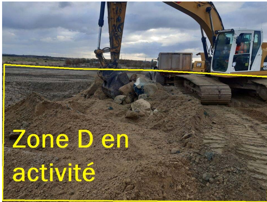
Figure 85 : Travaux en cours en Décembre 2021 sur la « zone D » (photo HAROPA PORT)
